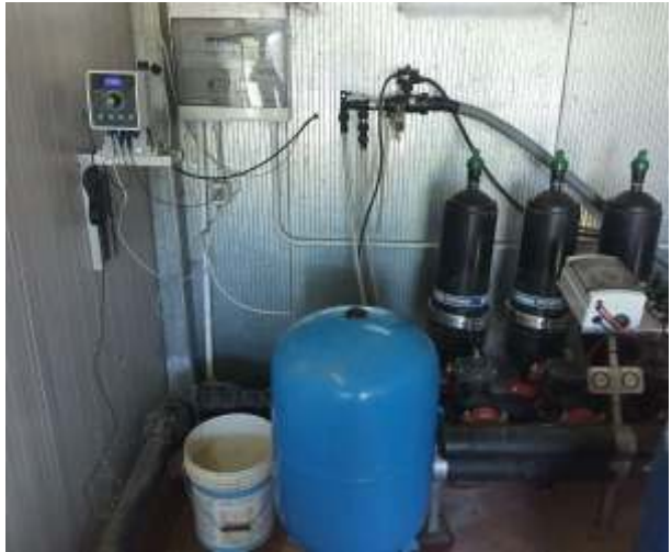
Impianto di filtrazione con sistema di lavaggio automatico foto Moreno Moraldi
